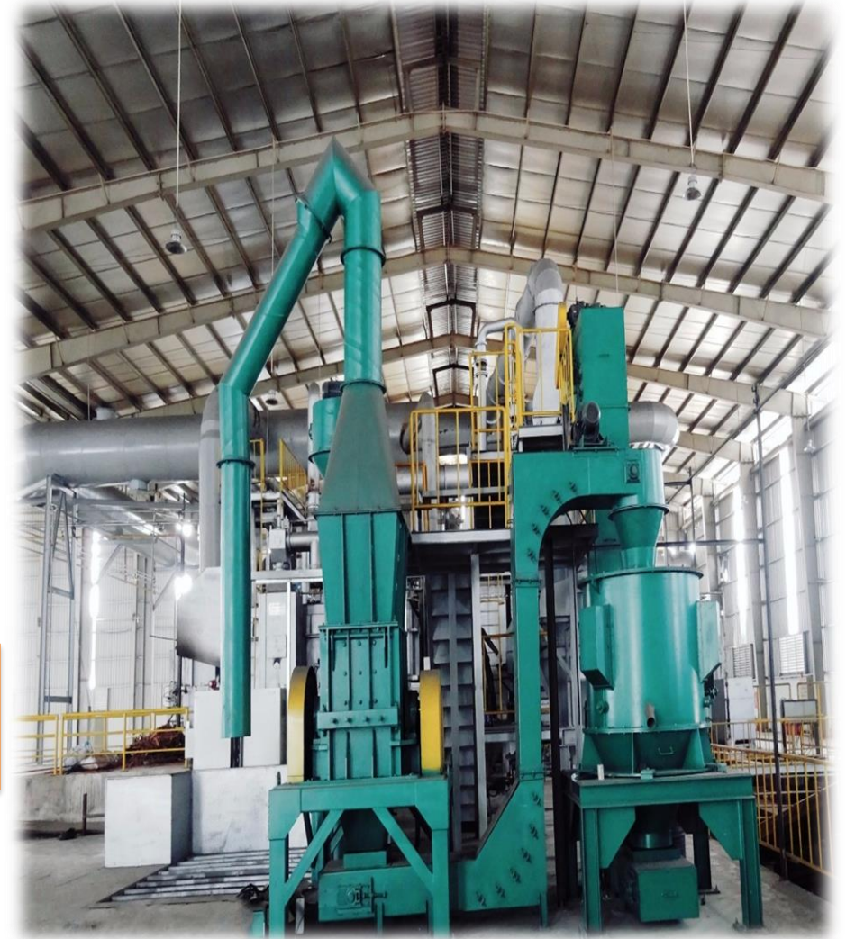
Hình ảnh : Hệ thống lò tái chế phoi (Image) (Chip recycle system)
