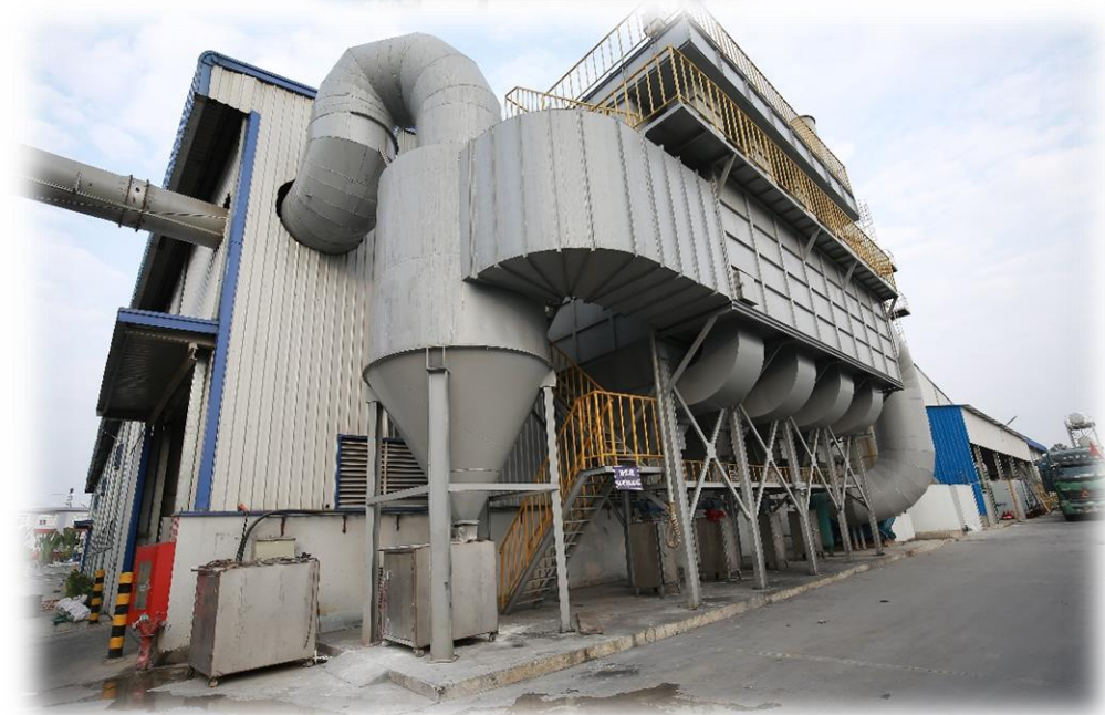
Hình ảnh : Hệ thống xử lý khí thải (Image) (Emission treatment system)
