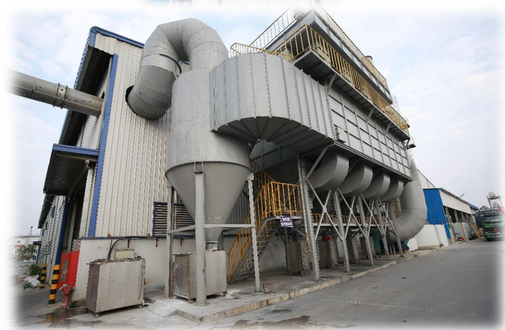
Hình ảnh : Hệ thống xử lý khí thải (Image) (Emission treatment system)
